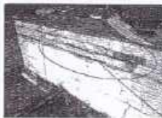
(나) 옥상 파라넷 균열
