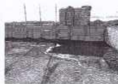
(다) 옥상 슬래브 물고임
