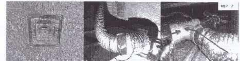
(가) 천장 디퓨저 (나) 환기 주철관 체결 미흡 (다) 천장 속 주철덕트
