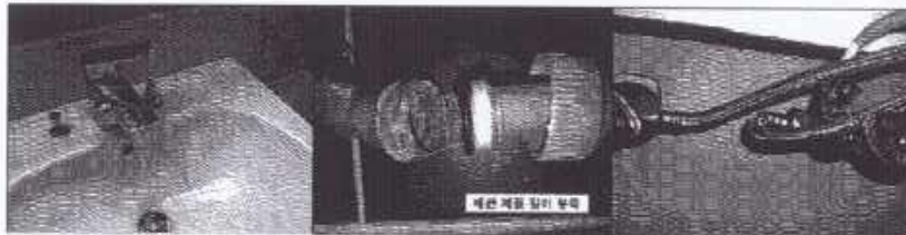
(가) 세면기 수전 (나) PB관 체결 길이 부족 (다) 워셔기구 플렉시블 호스 꺾임 과다
